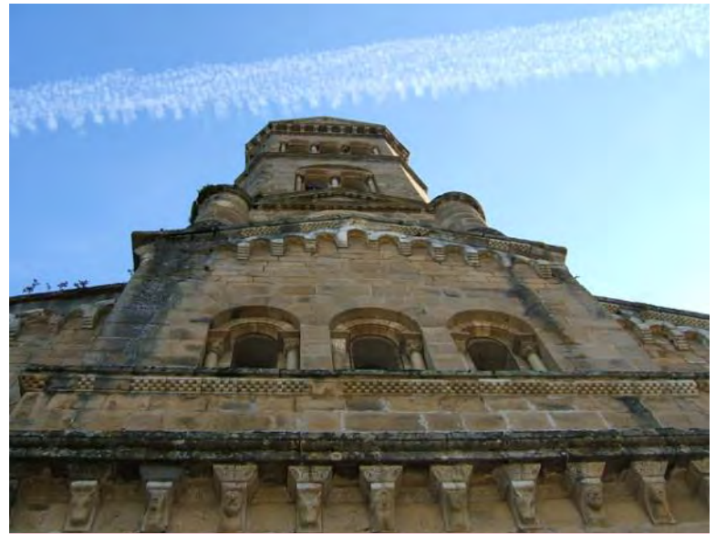
Baies en plein cintre, arcatures aveugles, décors de billette et frise de modillons sur la façade de l'église St-Barthélémy d'Oust
